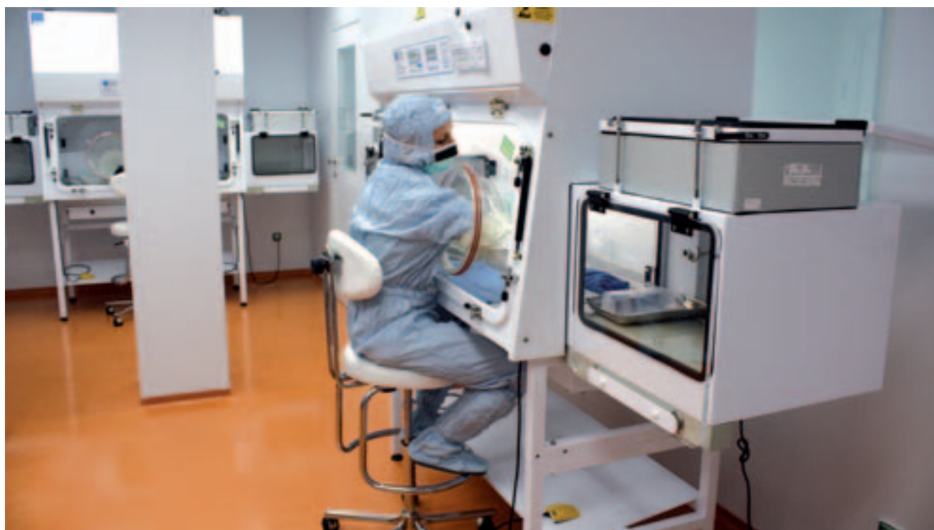
Nemocniční lékárna FN Motol – Centrum ředění cytostatik
